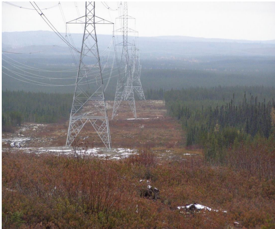
Figure 6 - Ligne électrique au site Rose
