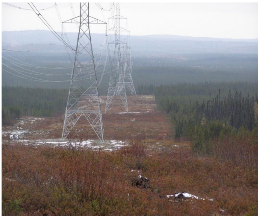
Figure 6 - Ligne électrique au site Rose
