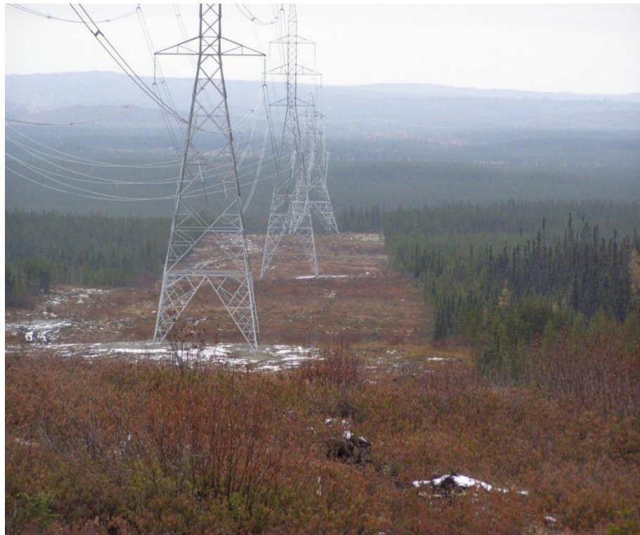
Figure 6 - Ligne électrique au site Rose
